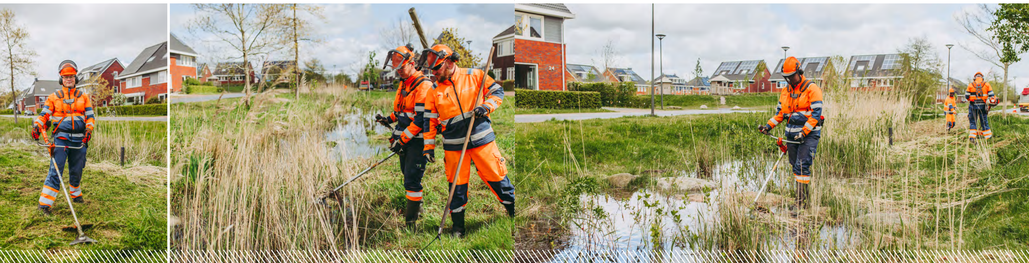
We krijgen vaker te maken met hevige neerslag. Daarom leggen we wadi's aan. Hier kan het water langzaam in de grond zakken. Het zijn ook biodiversere plekken die soms voor kinderen uitnodigen om te spelen.
