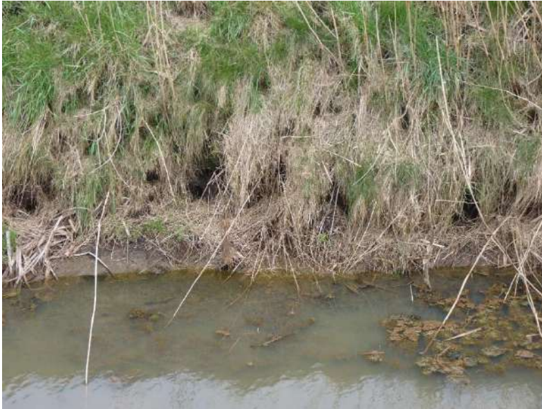
Foto 17 In veel oevers waren holletjes van muizen en ratten aanwezig.
