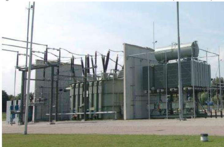
Figuur 5.2 Voorbeeld transformator in een transformatorcel (scherfmuren)
