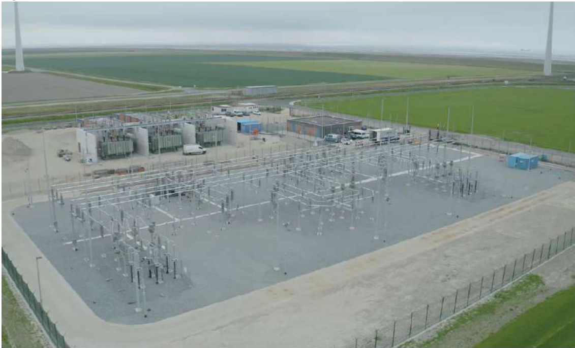
Figuur 4.6 Voorbeeld HS-station
