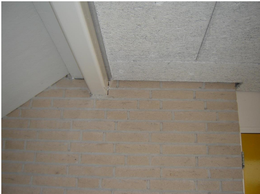
Foto 20: Staalconstructie trappenhuis opgelegd in metselwerk. Niet verankerd!
