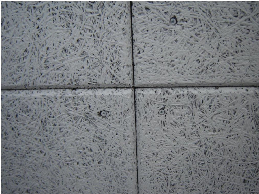
Foto 14: Mechanische bevestiging houtwolcement plafondplaten.
