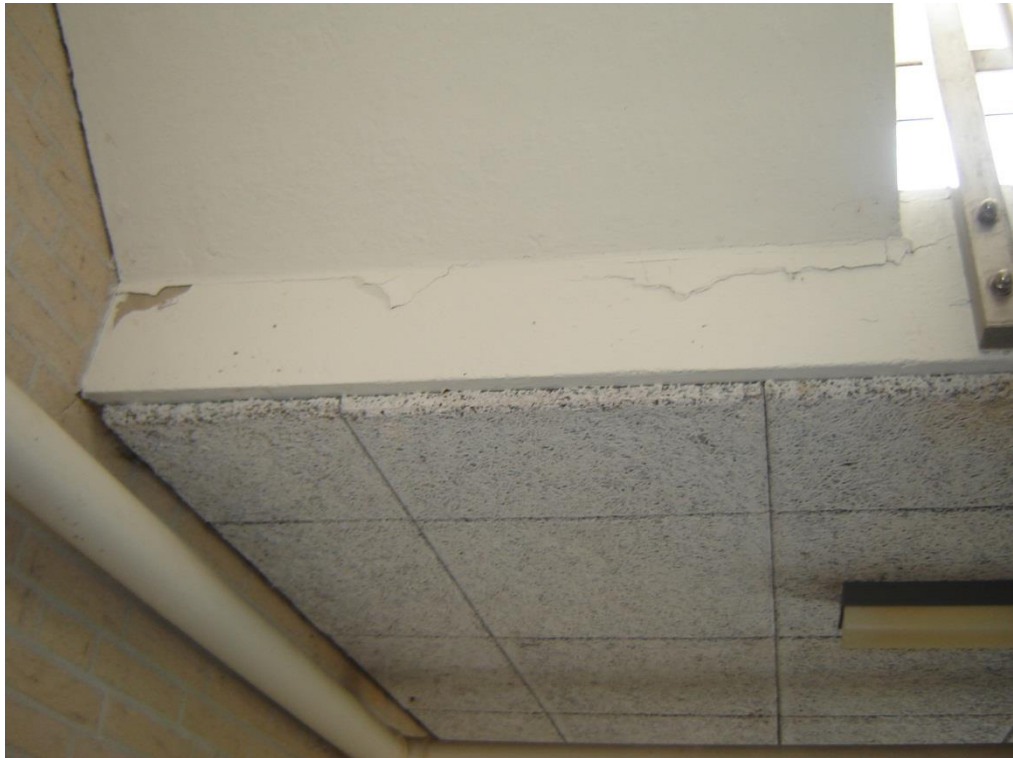
Foto 39: Oplegging prefab trap is verschoven.
