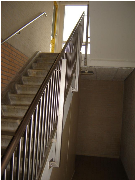
Foto 18: Prefab trappen met RVS balustrade in trappenhuis eindgevel.
