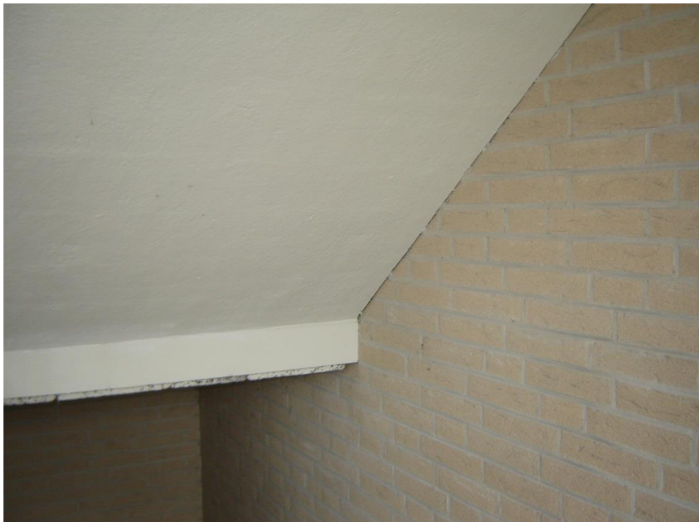
Foto 24 :Voeg tussen prefab trappen en metselwerk.
