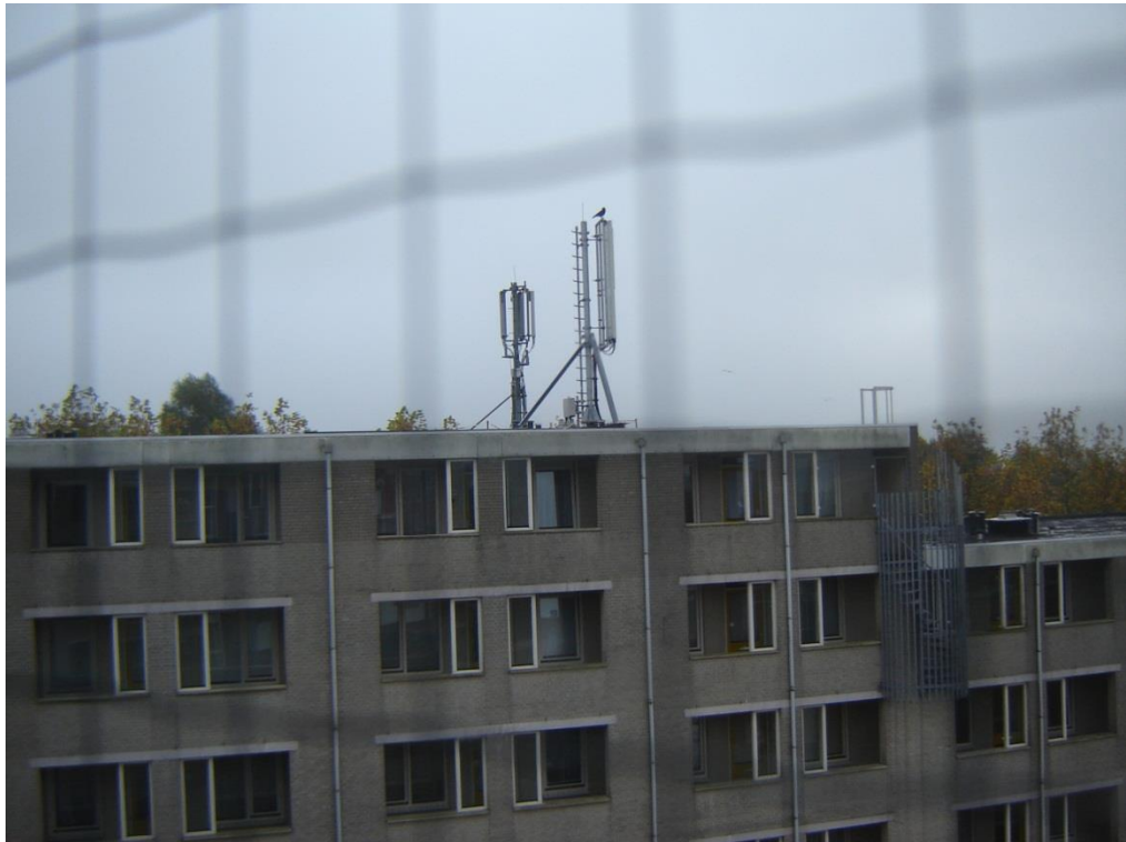
Foto 23: Antennes op het dak.
