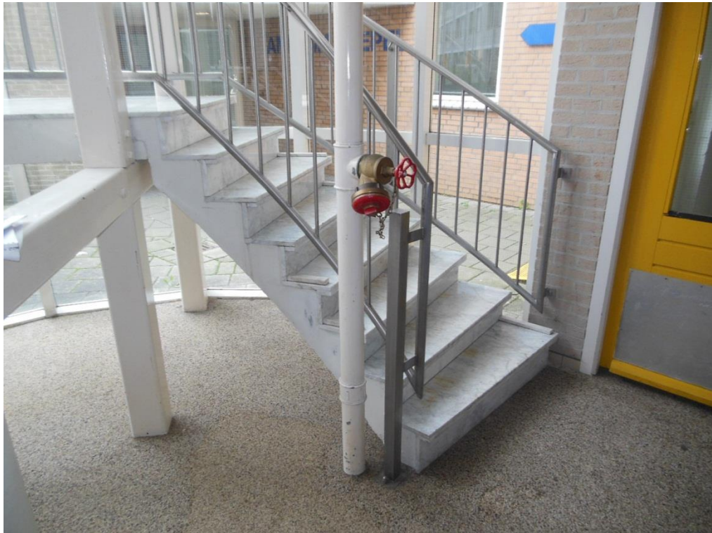
Foto 13: Droge blusleiding in hoofdtrappenhuis.
