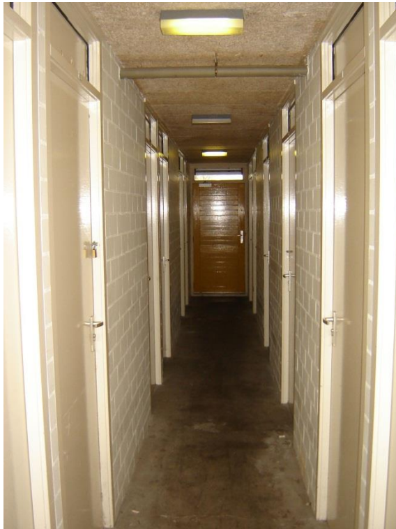
Foto 15: Gang bergingen. Niet dragend metselwerk ongesteund.
