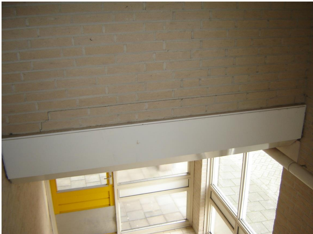
Foto 38: Metselwerk ongesteund opgelegd op vloer en gescheurd.
