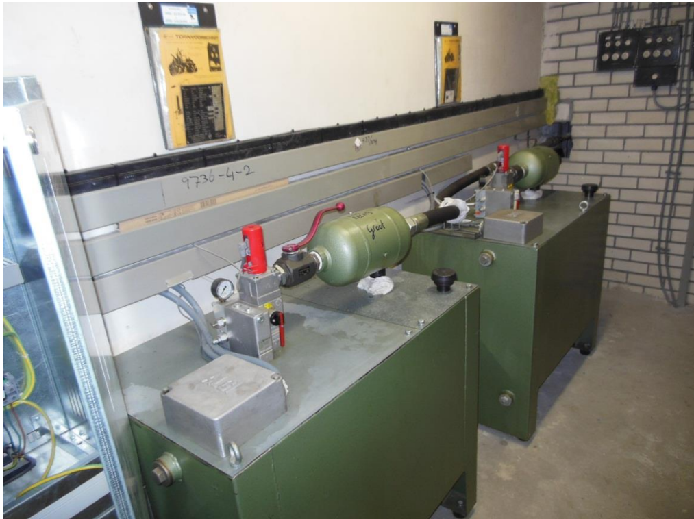
Foto 41: Liftinstallatie hydraulische lift.
