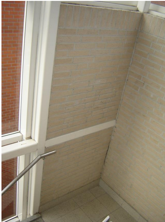
Foto 21: Metselwerk vulling in staalconstructie niet verankerd.
