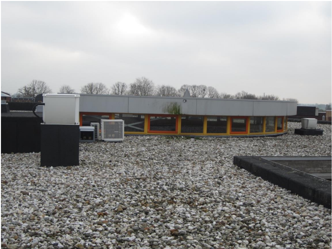
Figuur 16: Stalen dakopbouw boven vide bouwdeel D
