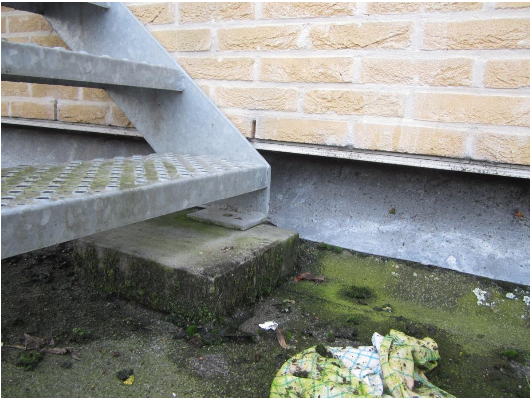
Figuur 29: Stalen noodtrap niet verankerd aan dak
