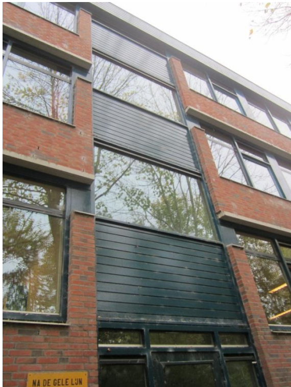
Foto B6: Gestapelde pui bij noodtrappenhuis.
