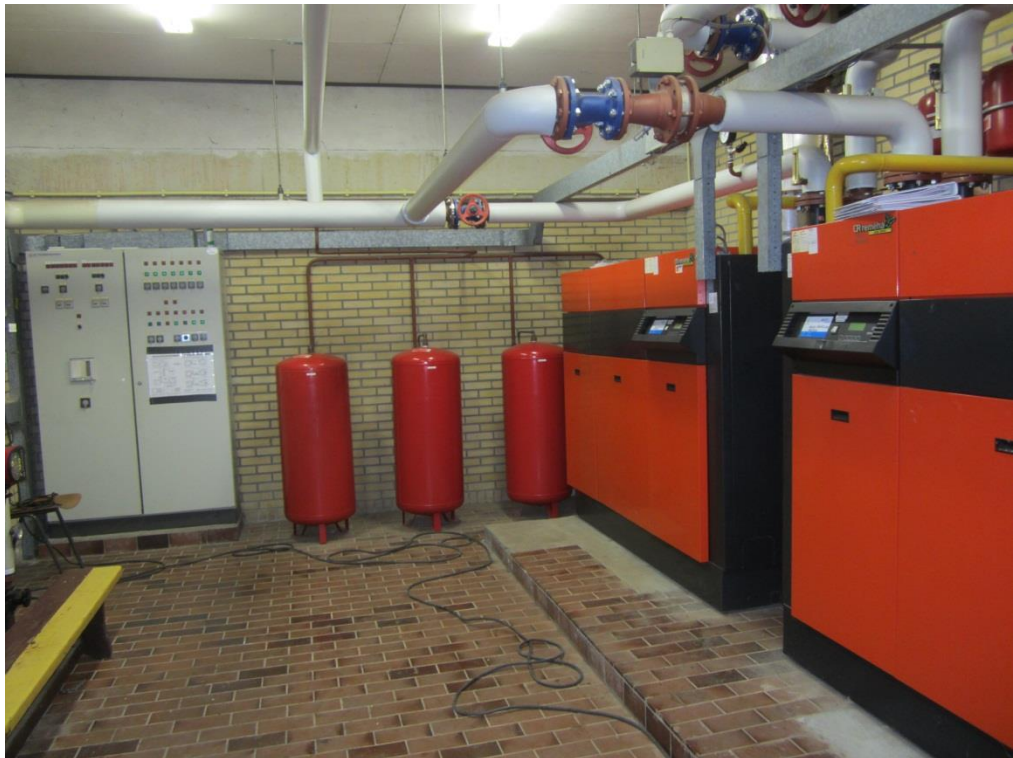
Foto B12: Onlangs vernieuwde verwarmingsinstallatie en regelkast.
