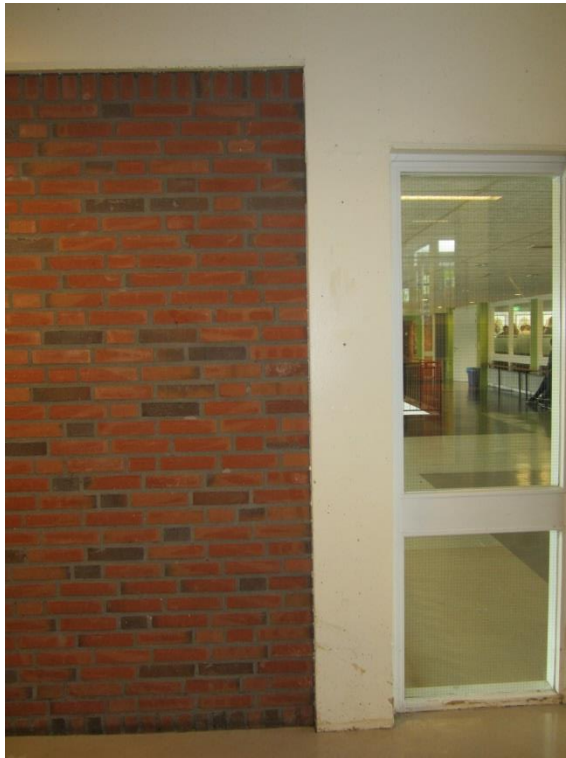
Foto C5: Steens metselwerkwand 'opgesloten' tegen betonnen kolom.
