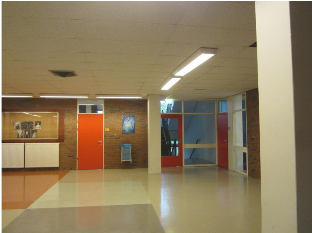
Foto B11: Overzicht systeemplafond met verlichting.
