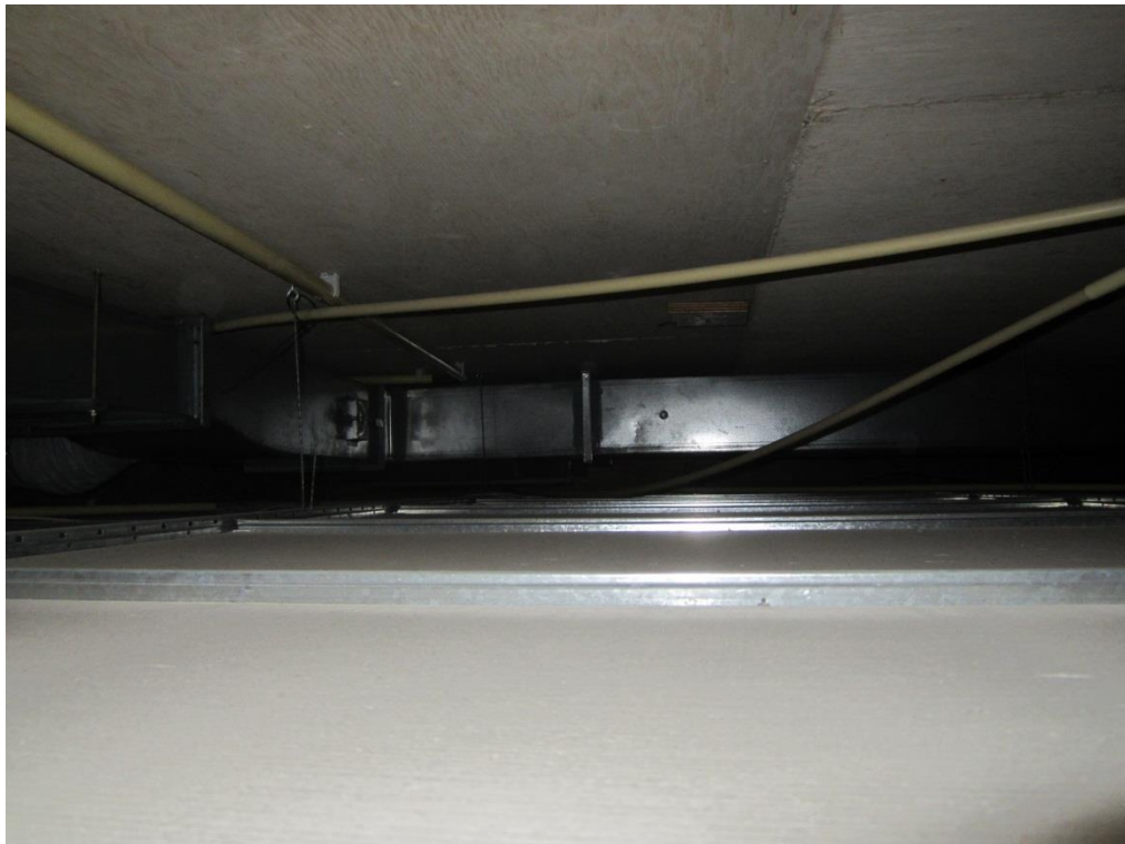
Foto B14: Ventilatiekanaal boven systeemplafond.
