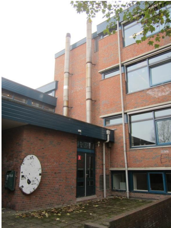
Foto B5: Doorgemetselde gevel en rookgasafvoer in de Oostgevel.
