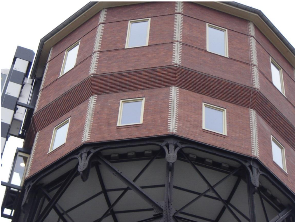
Foto B2: Gevelmetselwerk met wandopeningen en (horizontale) dilataties.
