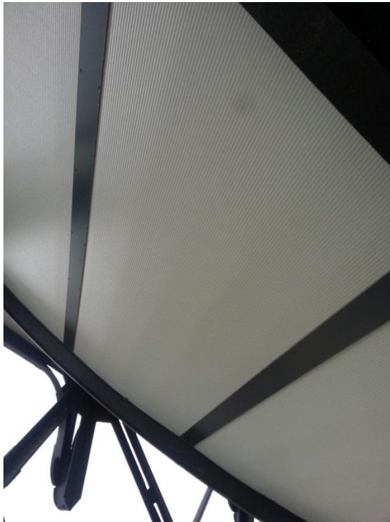
Foto B7: Plafondpanelen onder lekszolder toren.
