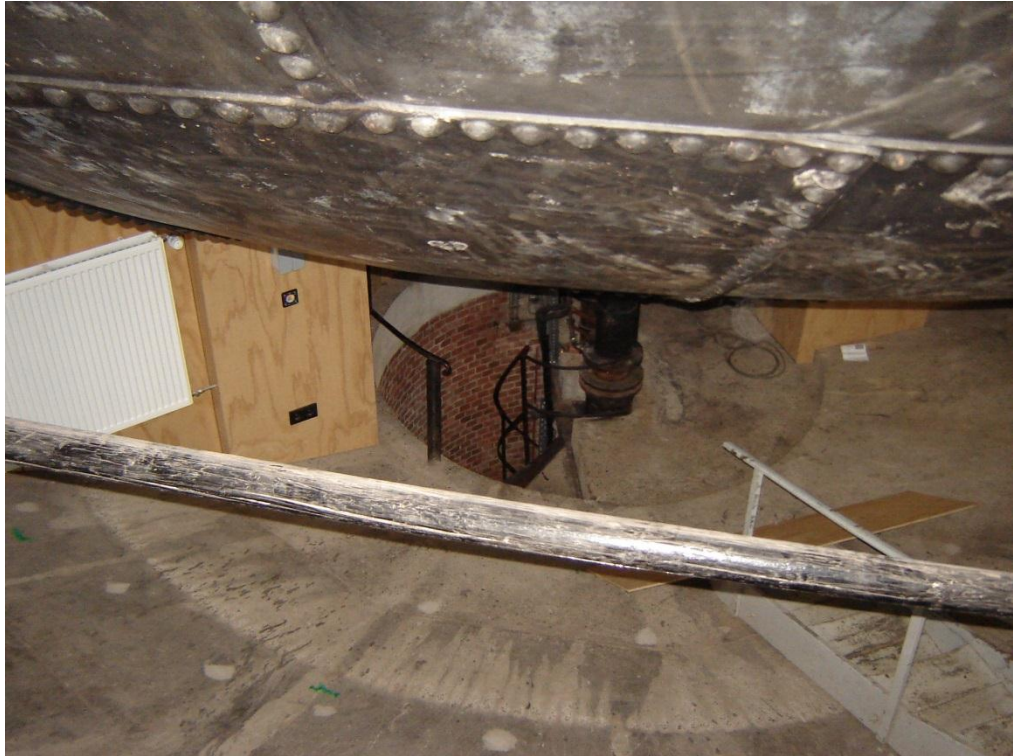
Foto C3: Betonnen schaalvloer tbv condenswater.
