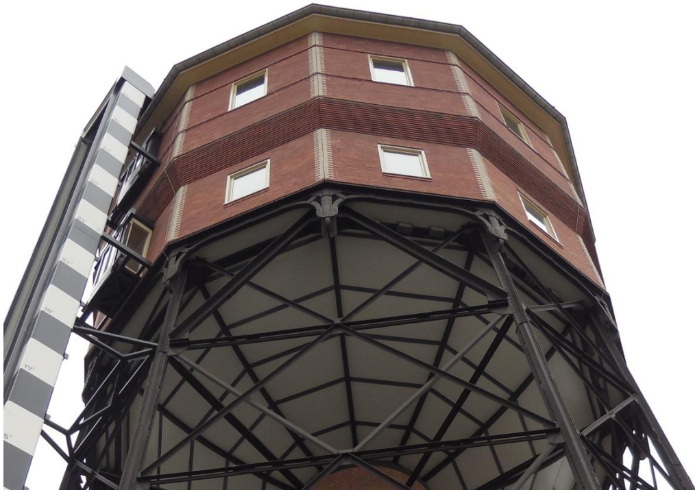
Foto C5: Verzwaarde verbanden bovenste vak stabiliteitsverband.
