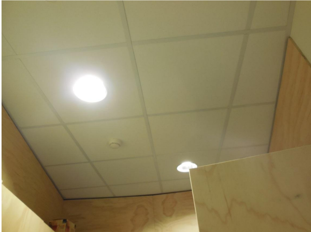
Foto B12: systeemplafond v.v. spots.
