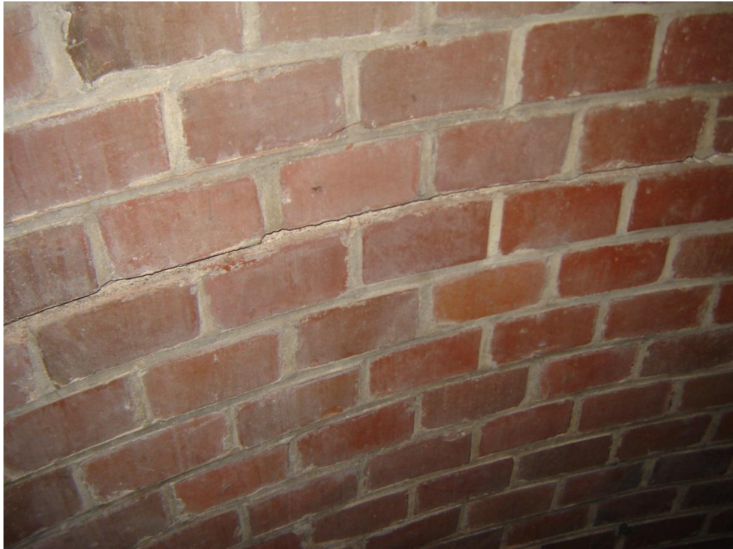
Foto B5: Scheur in metselwerkschacht.
