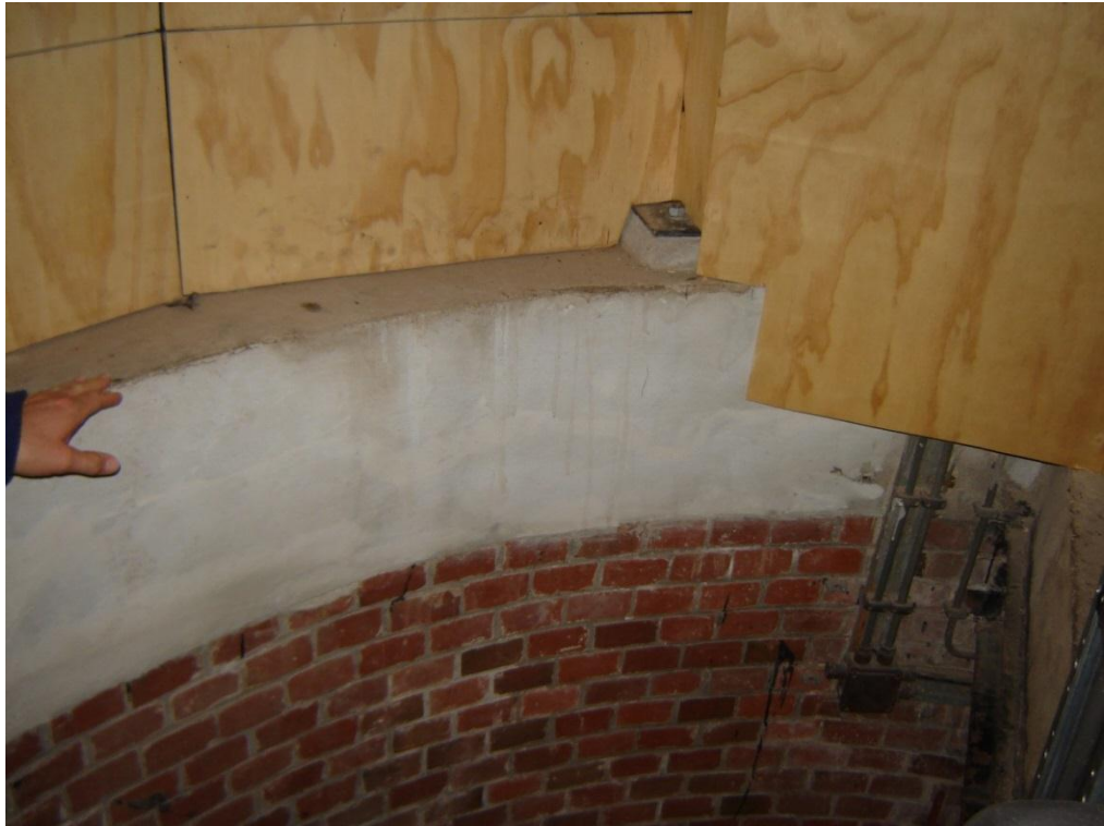
Foto C9: Betonnen rand t.p.v. bovenkant schacht.
