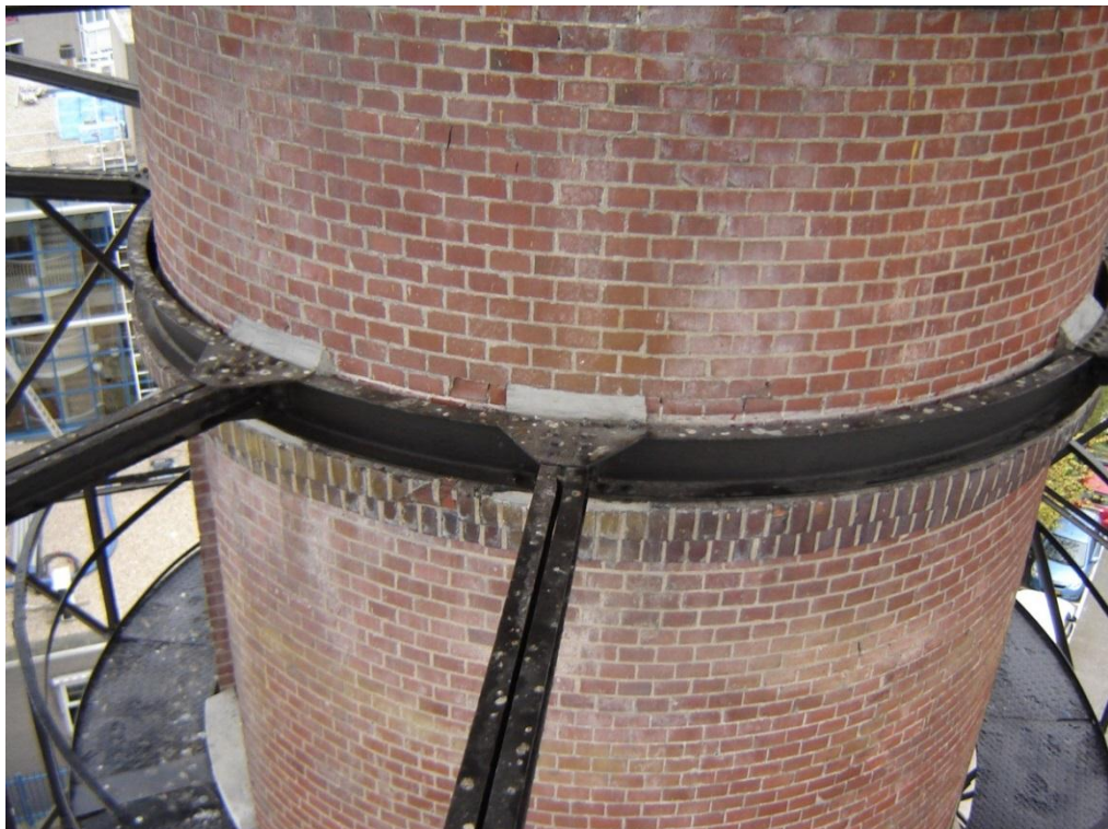
Foto B4: Metselwerk schacht met stalen band.
