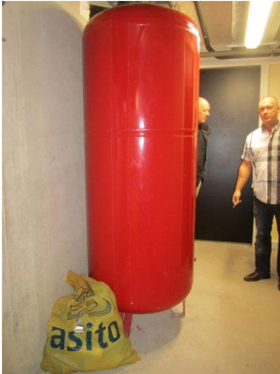
Foto B9a: Niet verankerde installatieonderdelen
