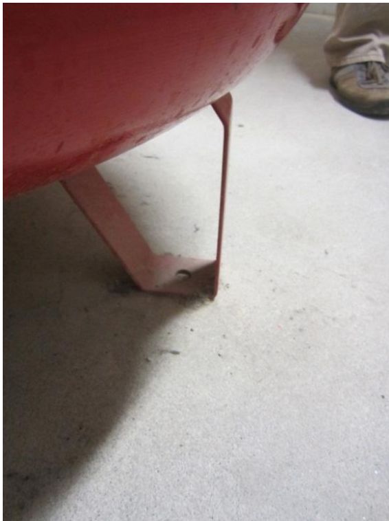
Foto B9b: Niet verankerde installatieonderdelen
