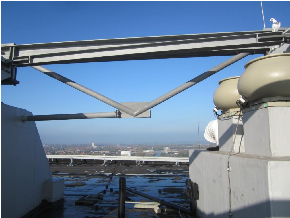
Foto C9: Onderbroken verband t.b.v. luchtbehandeling
