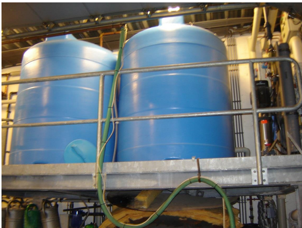
Foto 35: Opstelling vaten in installatieruimte.
