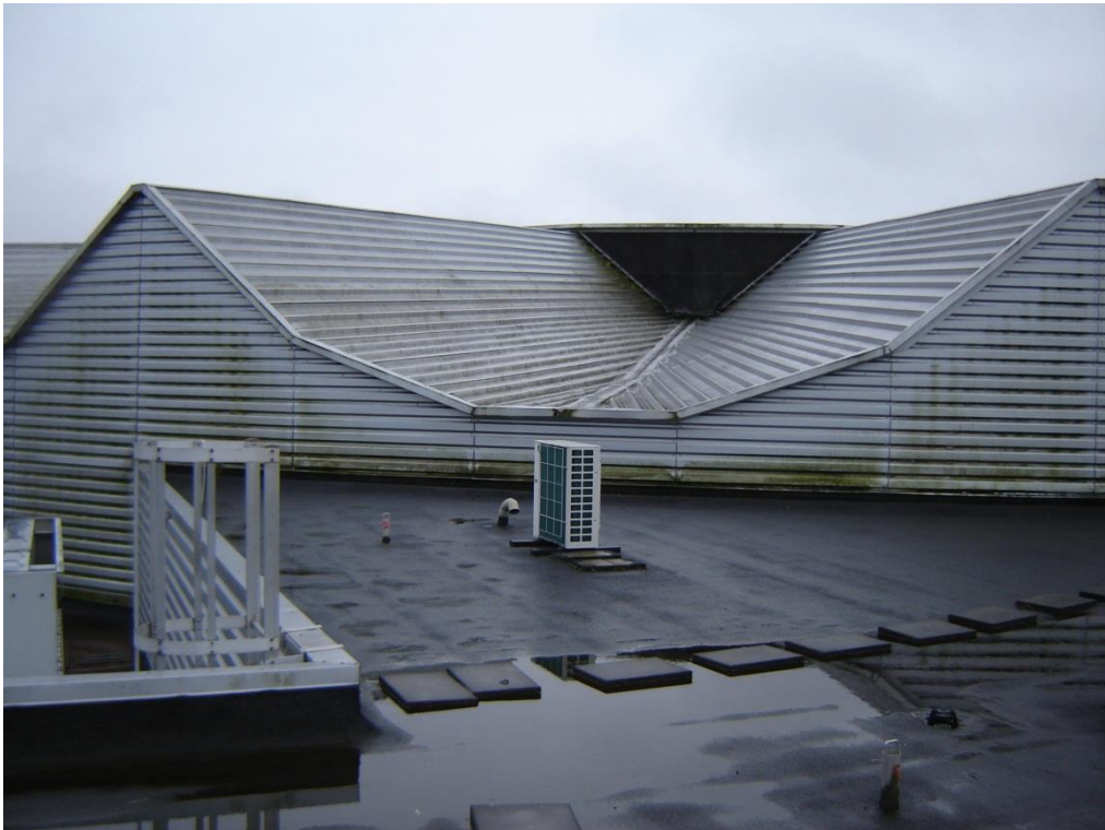
Foto 45: Opstelling op dak.
