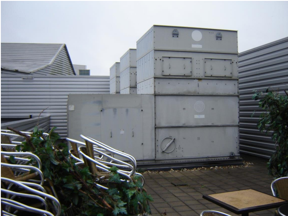
Foto 41 Buitenopstellingen t.b.v. ijsinstallaties.
