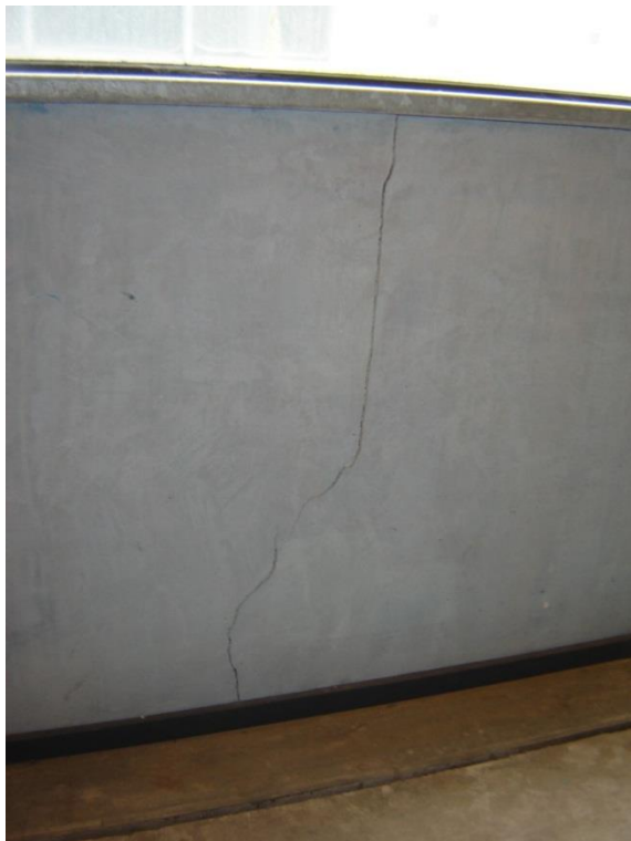
Foto 26: Scheuren in metselwerk vulling.
