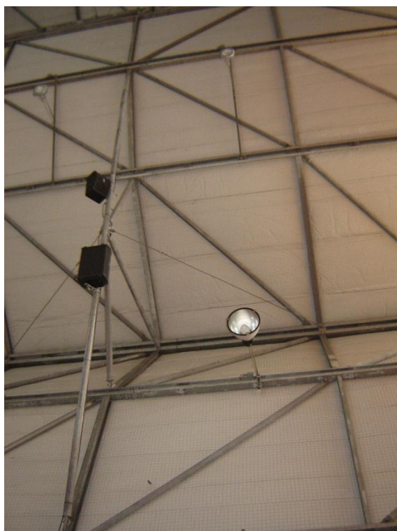
Foto 30: Installaties aan dak in de ijshockeybaan.
