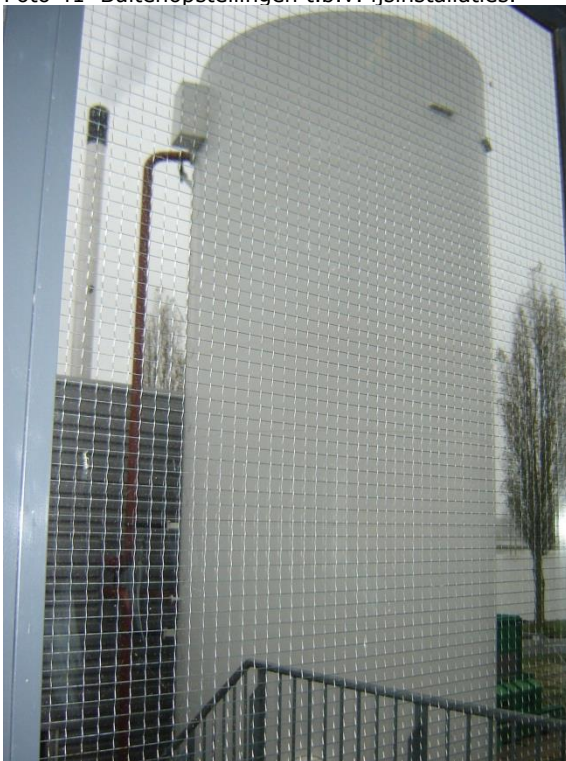
Foto 42 Opstelling houtverwarming nabij nooduitgang ijshockeybaan.
