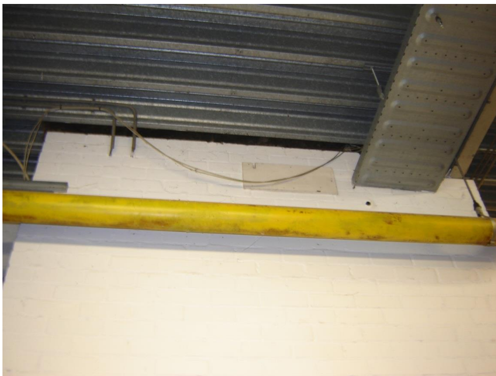
Foto 36: Metselwerk aan bovenzijde niet gesteund.
