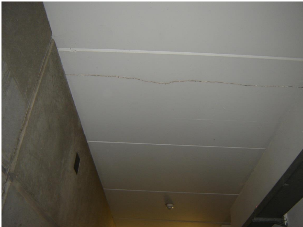
Foto 28: Scheur in kanaalplaatvloer verdiepingsvloer ijshockeybaan.
