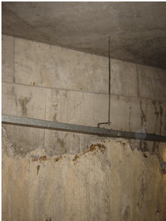
Foto 10: Ophanging kabelgoot aan lange draadeinden t.p.v. de inrit.
