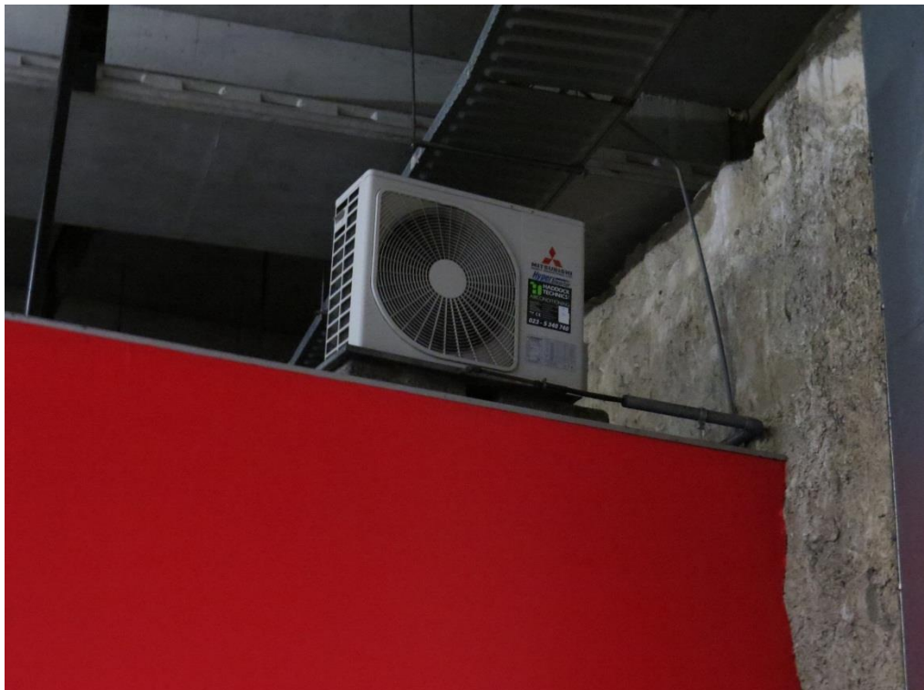
Foto 14: Airco op dak portiersloge.
