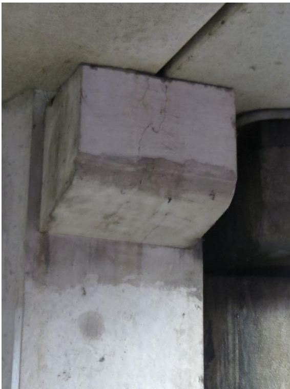
Foto 48: Nok aan prefab kolom. Let op de scheur!
