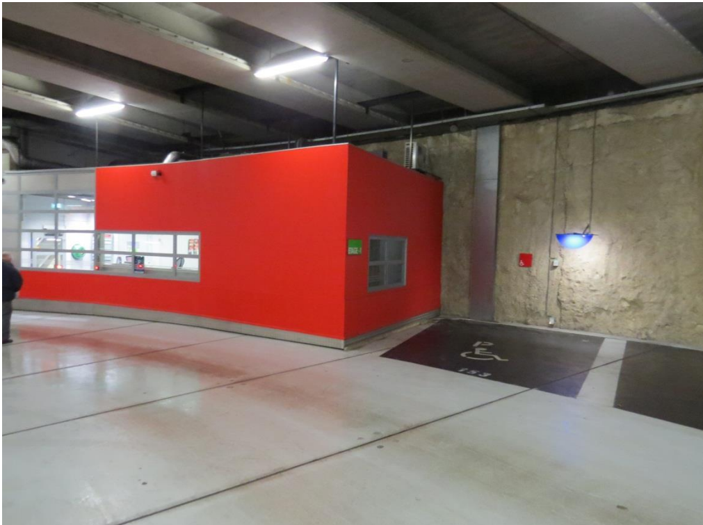
Foto 12: Portiersloge. Dak is opgehangen aan het kelderdek.
