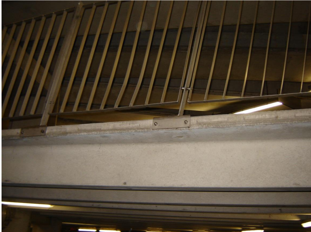
Foto 25: Bevestiging hekwerken langs rijbaan.
