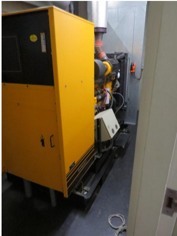
Foto 21: Noodaggregaat naast NSA ruimte (diesel).
