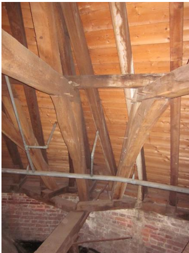
Figuur 33, Sprinklerinstallatie in kap
