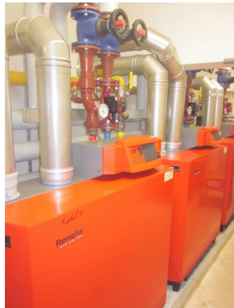
Figuur 34, Technische ruimte
