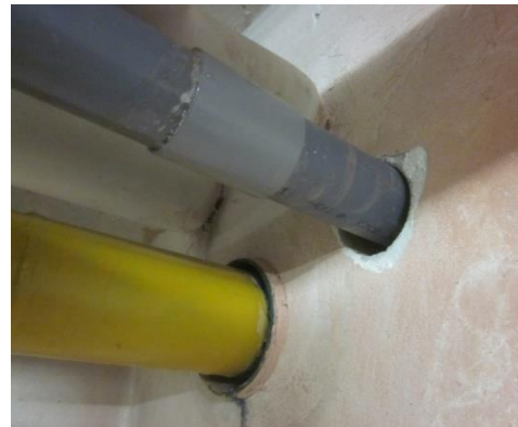
Figuur 36, Binnenkomst gasleiding in kelder
