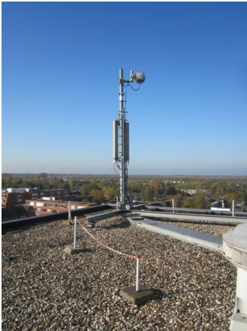
Foto B19: Bevestiging UMTS mast
