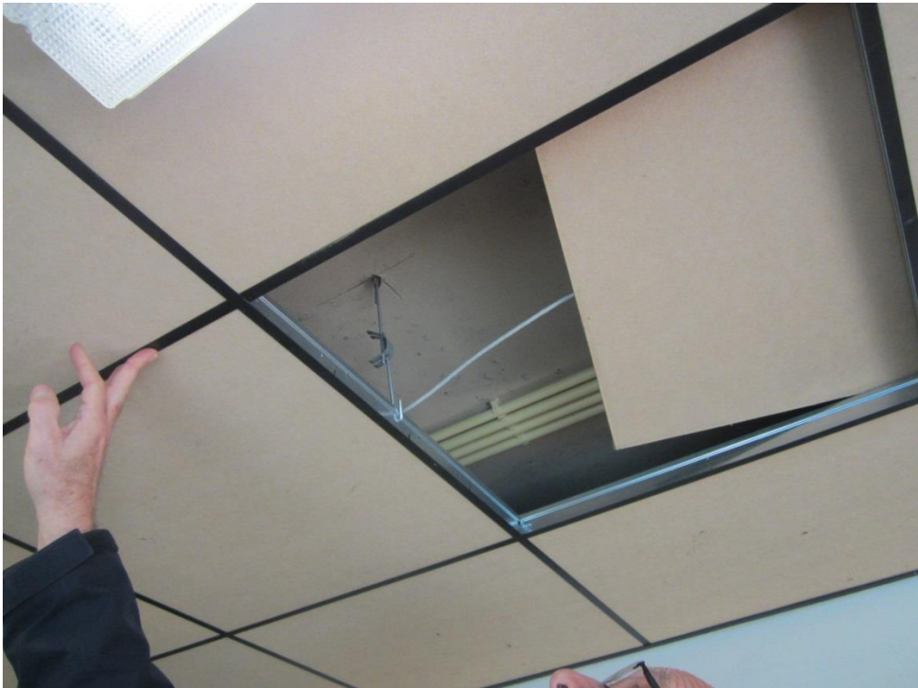
Foto B11: Systeemplafond begane grond
