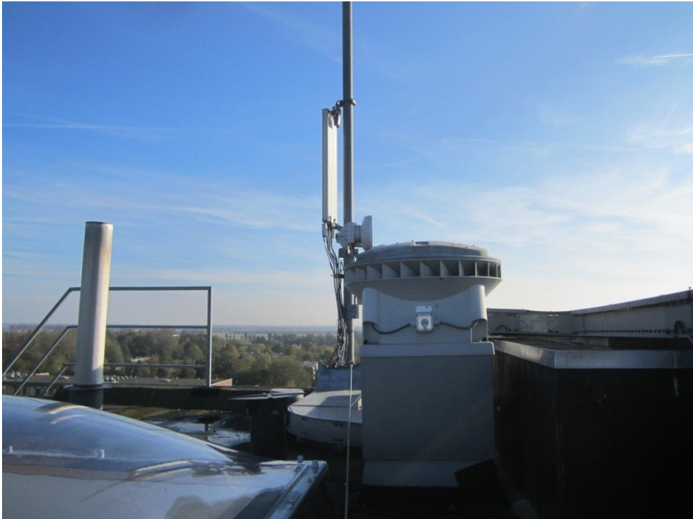
Foto B18: Afzuigventilator woningen
