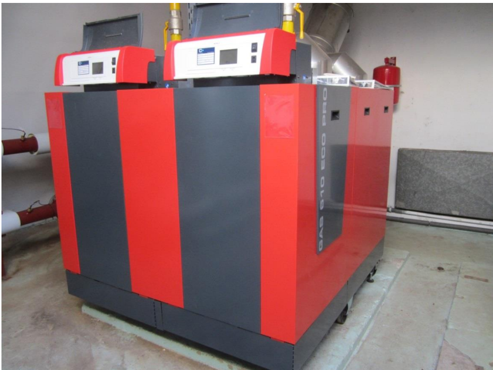
Foto B16: CV ketel technische ruimte
