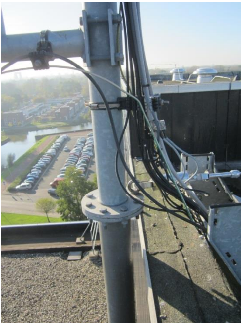
Foto B20: Bevestiging UMTS mast
