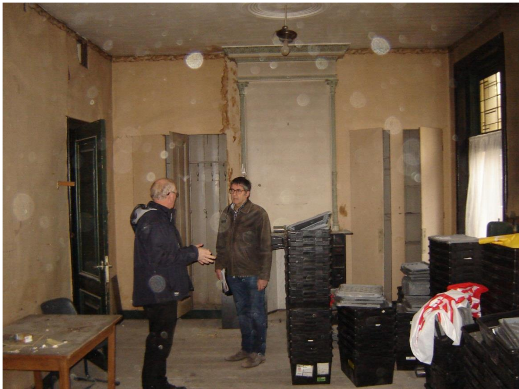
Foto 12: Oud metselwerk tweede verdieping.
