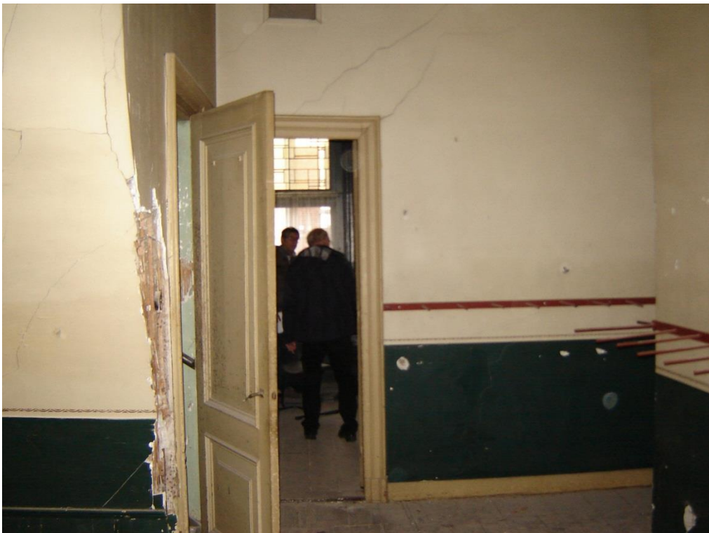
Foto 10: Gescheurde wanden op tweede verdieping.
