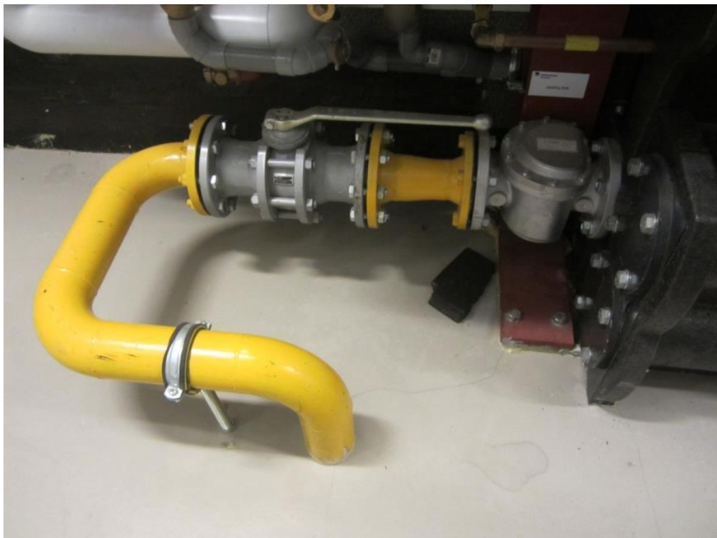
Foto 24: Doorvoer van gasleiding in vloer
