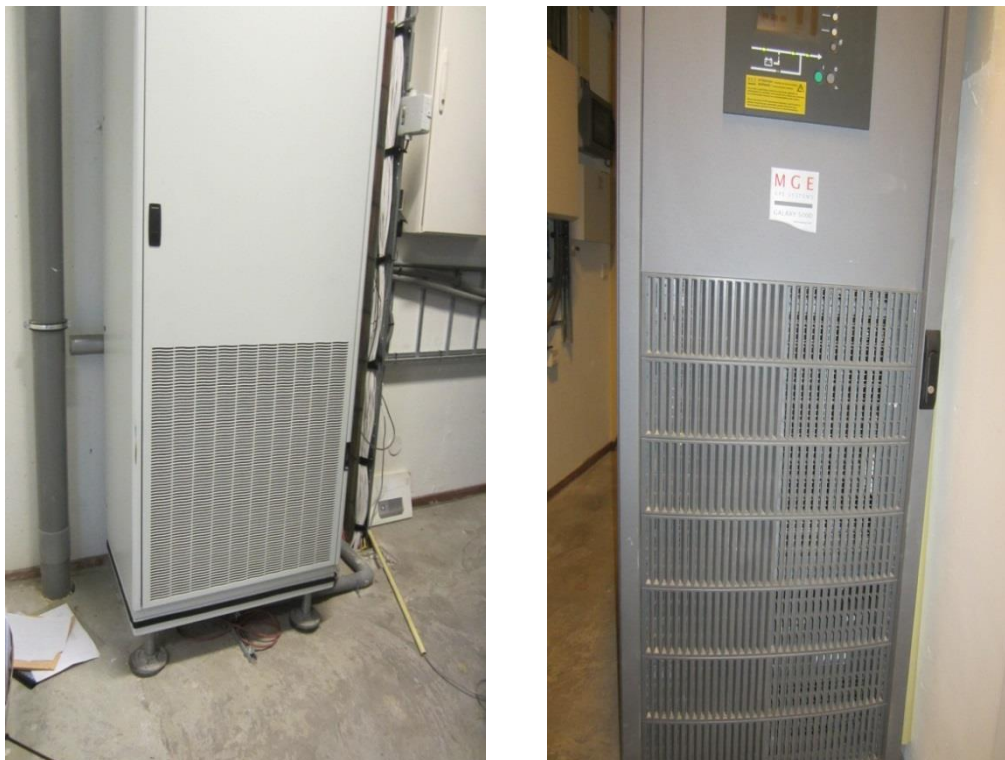
Foto 22: Niet verankerde hoge installatie elementen.
