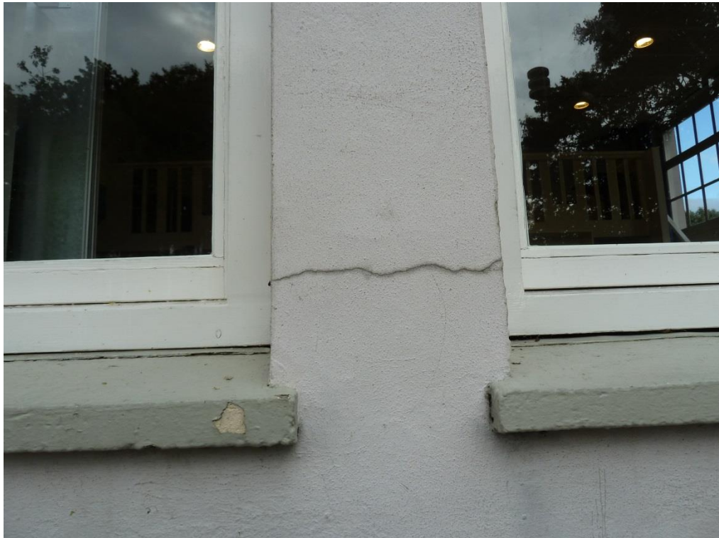
Foto 17: Scheurvorming metselwerk penant in de achtergevel (1)
