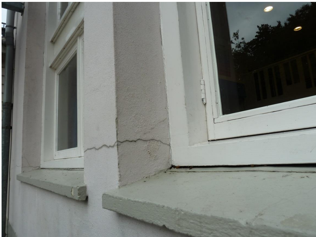
Foto 18: Scheurvorming metselwerk penant in de achtergevel (2)
