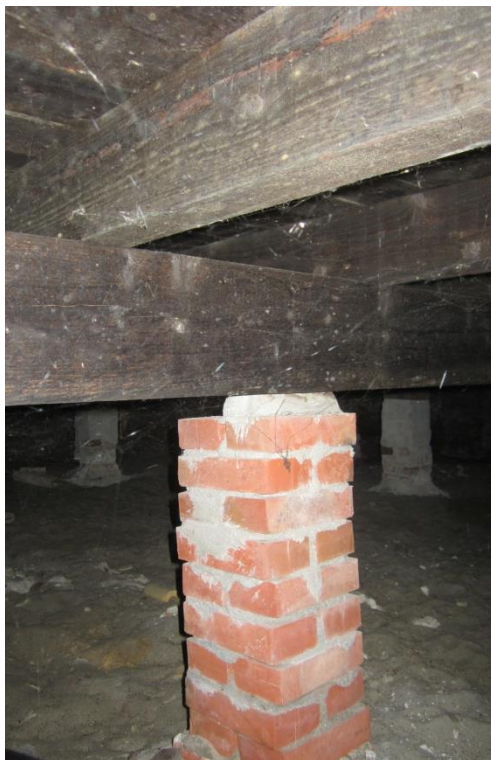
Foto 5: Oplegging op metselwerk stiepen
