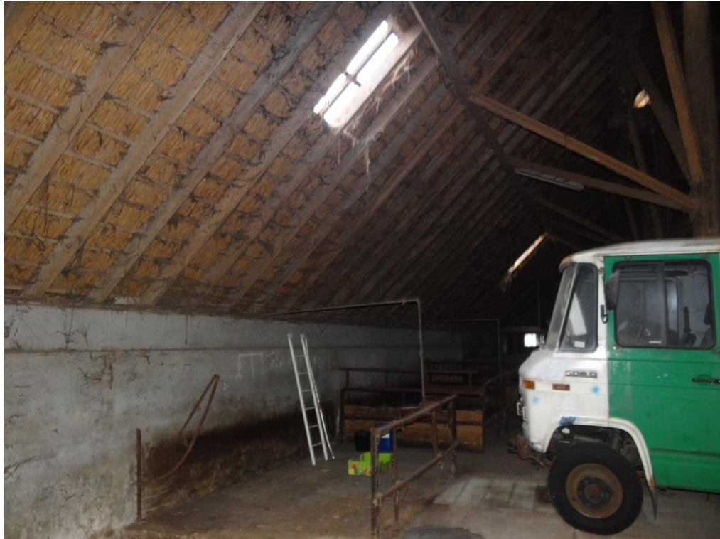
Foto 27: Buiten metselwerk van de schuur afgesteund met een muurplaat naar de kapconstructie.
