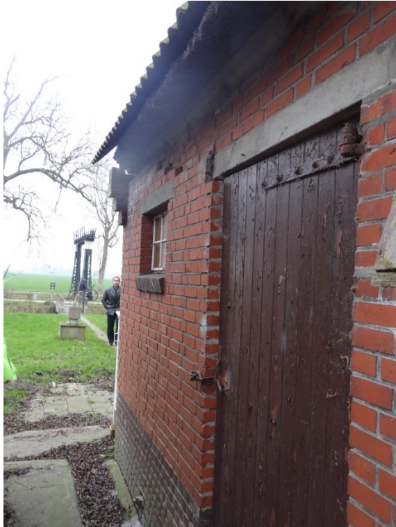
Foto 35: Ten gevolge van de zakking (foto 34) is het metselwerk in de zijgevel naar buiten gekomen.
