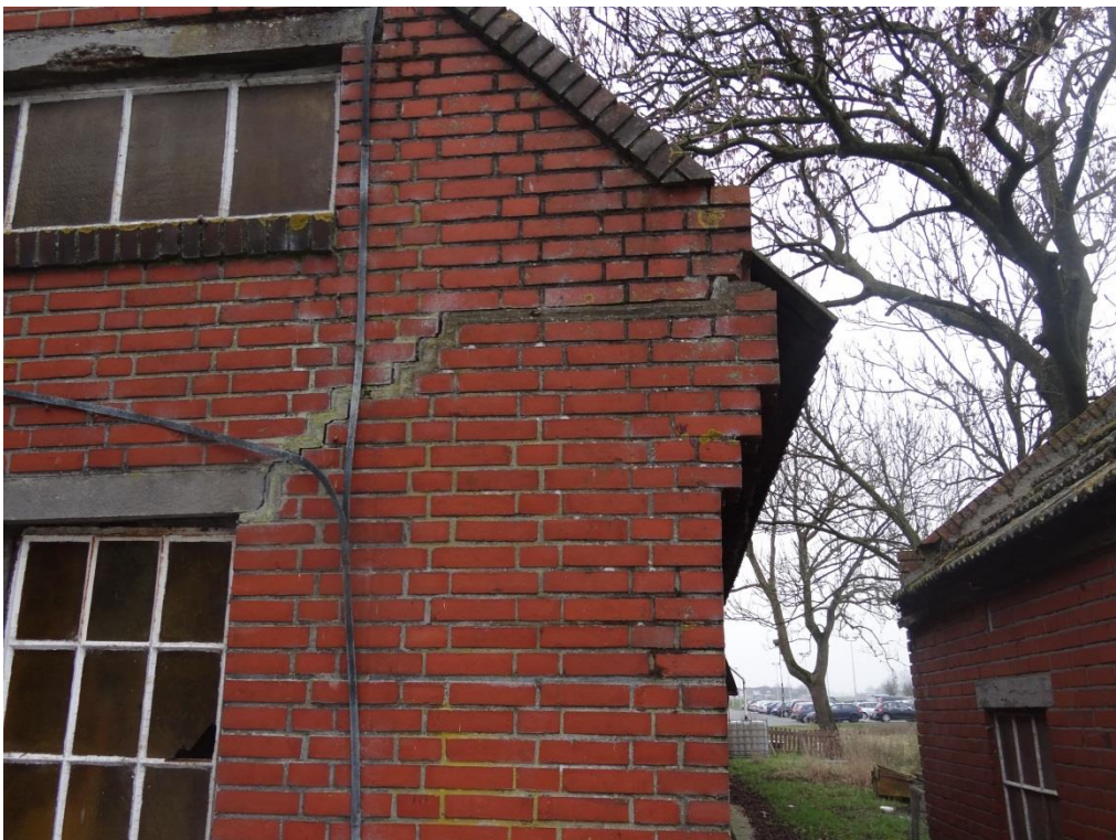
Foto 34: Verzakking van hoek voorgevel van de schuur.
