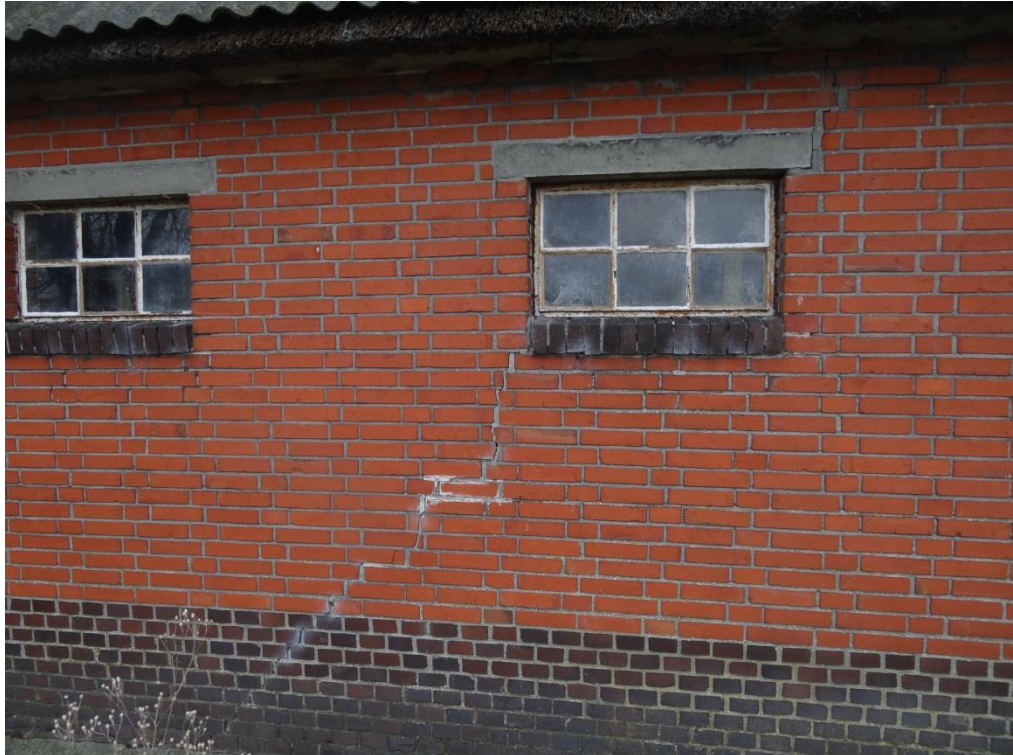
Foto 36: Scheurvorming in zijgevel schuur.
