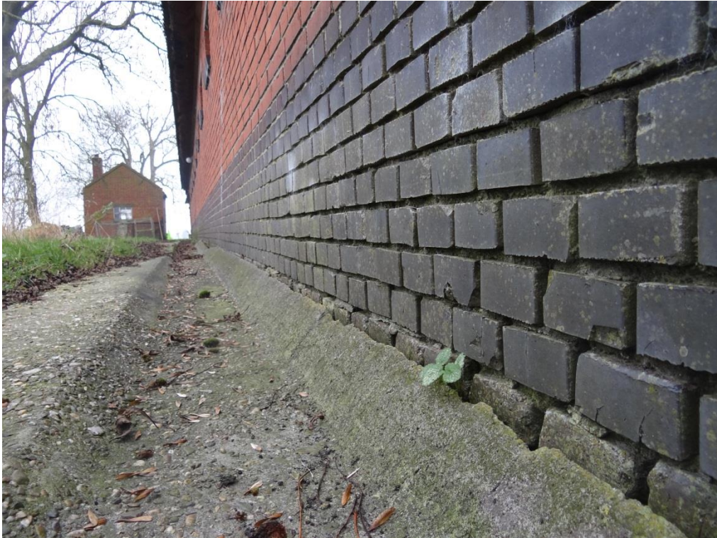
Foto 37: Voegen van het trasraam van de schuur zijn niet afgevoegd.
