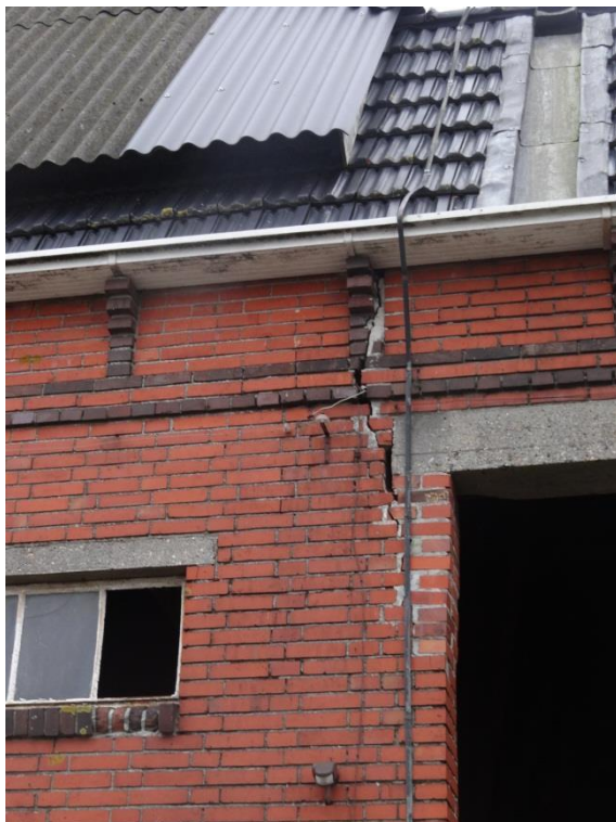
Foto 32: Scheurvorming achtergevel schuur.
