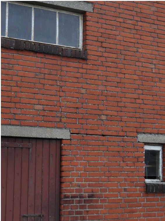
Foto 33: Horizontale scheurvorming achtergevel schuur.
