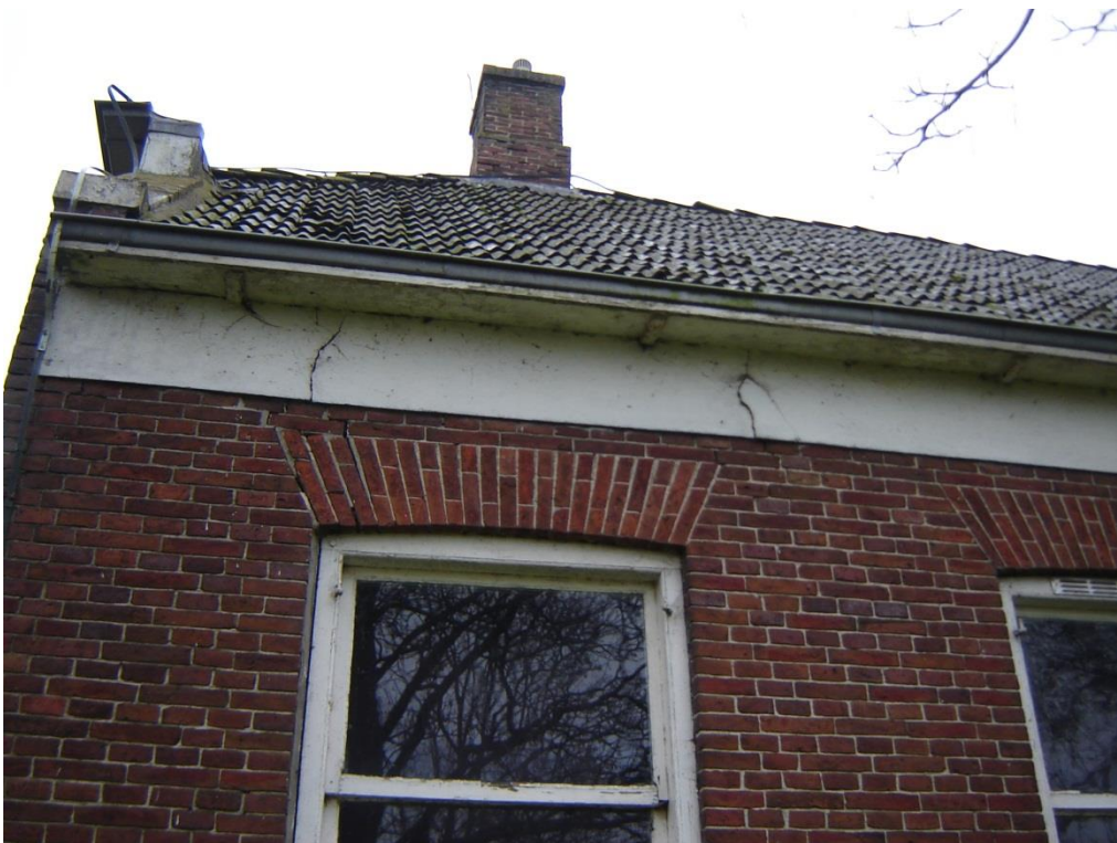
Foto 38: Dak woonhuis met gemetselde schoorsteen. Scheurvorming boven de hanenkam.
