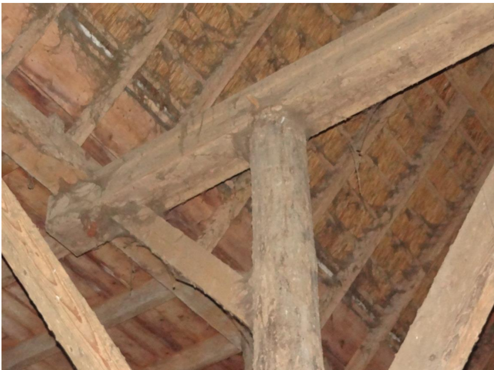
Foto 30: Oplegging balk op kolom.
