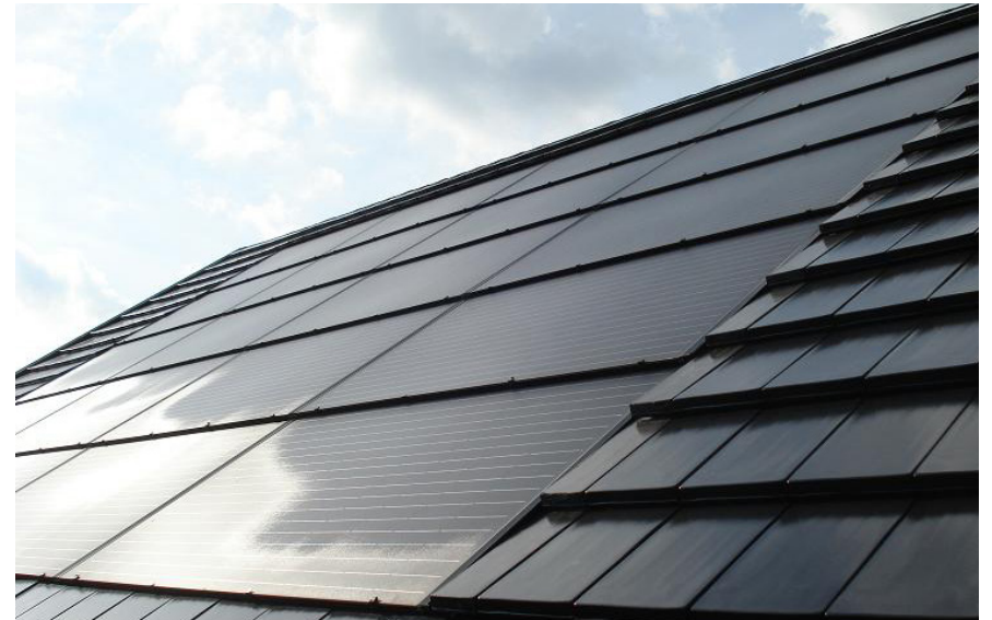
Zorgvuldig geïntegreerde zonnepanelen
