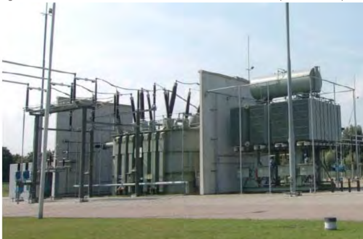
Figuur 5.2 Voorbeeld transformator in een transformatorcel (scherfmuren)
