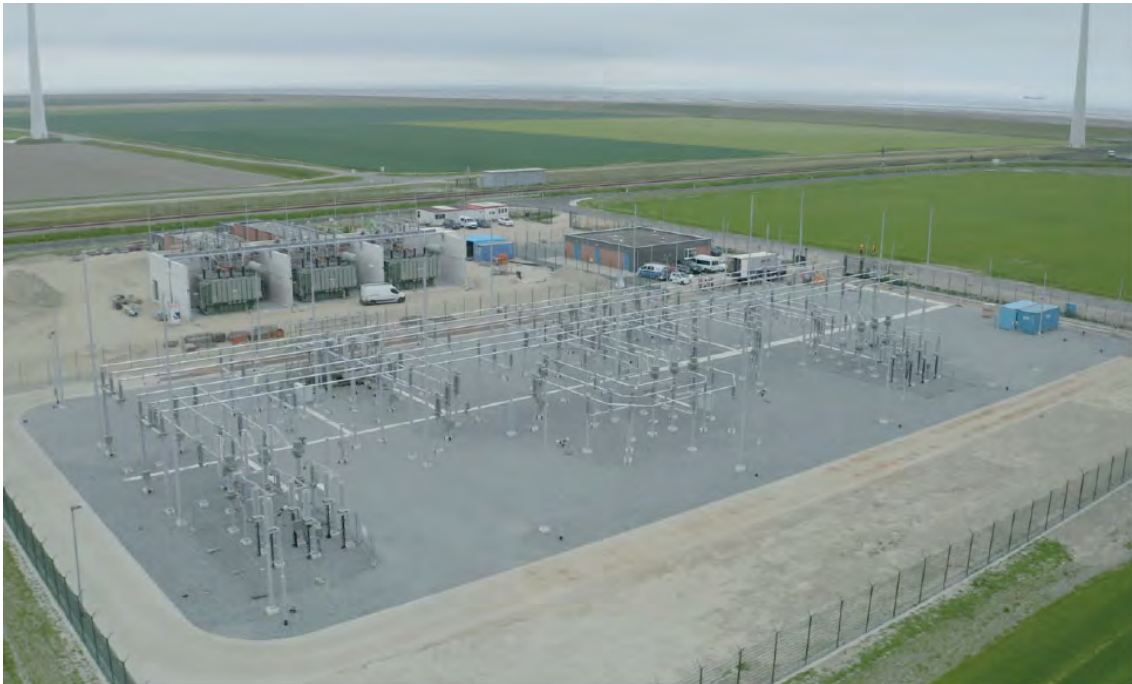
Figuur 4.5 Voorbeeld HS-station
