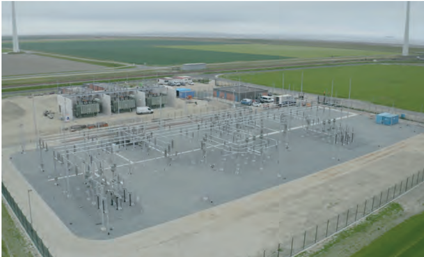
Voorbeeld van een middenspanningsstation (Eemshaven, bron: Tennet) 1
