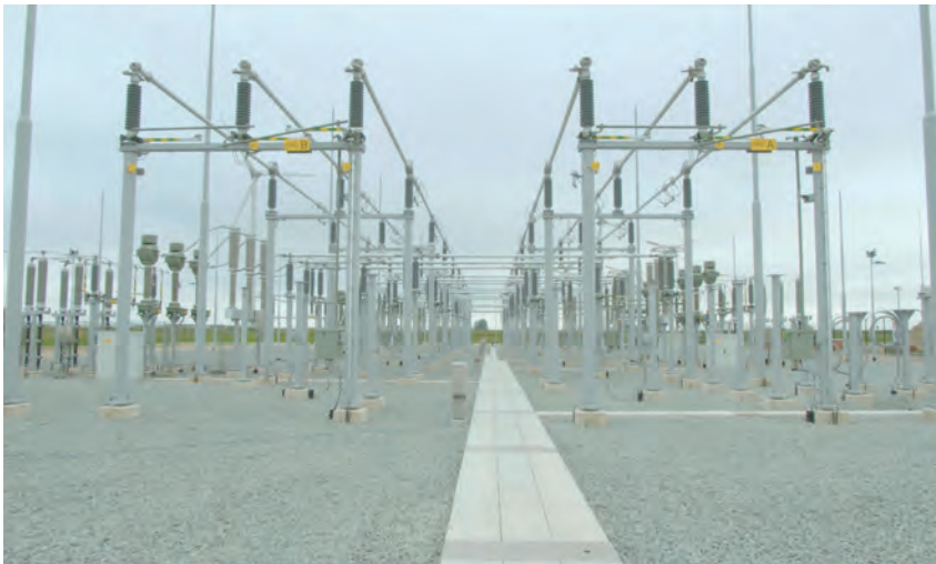
Voorbeeld van een middenspanningsstation (Eemshaven, bron: Tennet) 2
