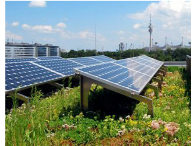
Afbeelding 111: Zonnepanelen op het dak | Leipzig
