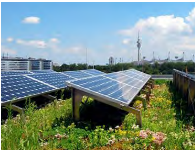
Afbeelding 40: Zonnepanelen op het dak | München
