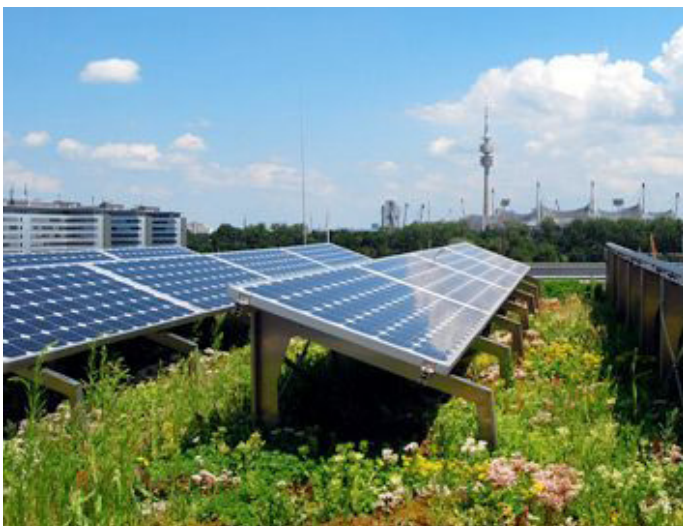
Afbeelding 40: Zonnepanelen op het dak | München
