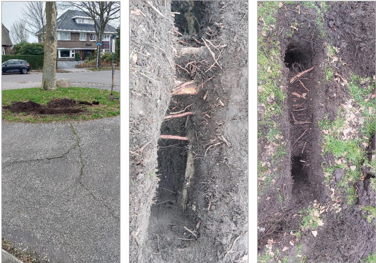
Afbeelding 30/31/32: Ook de wortels van plataan nr. 11 reiken niet diep. Aan de scheuren in het asfalt is te zien dat de wortels ook bij deze boom ver buiten de kroonprojectie zijn gegroeid. Het grensvlak asfalt-fundering is interessant voor boomwortels door, onder meer, de condensatie van water onder het asfalt.
