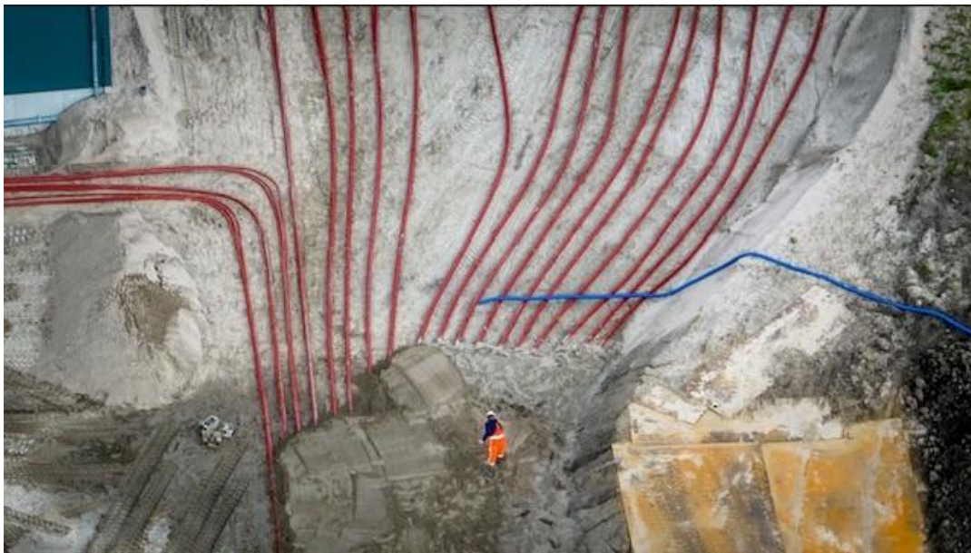
Figuur 5 ondergronds kabeltracé
