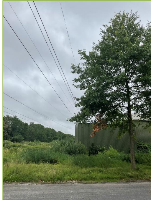
Figuur 38: Bovengrondse elektriciteitskabels en overhangende takken.
