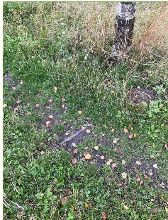
Afbeelding 31: Beworteling is bovengronds zichtbaar.
