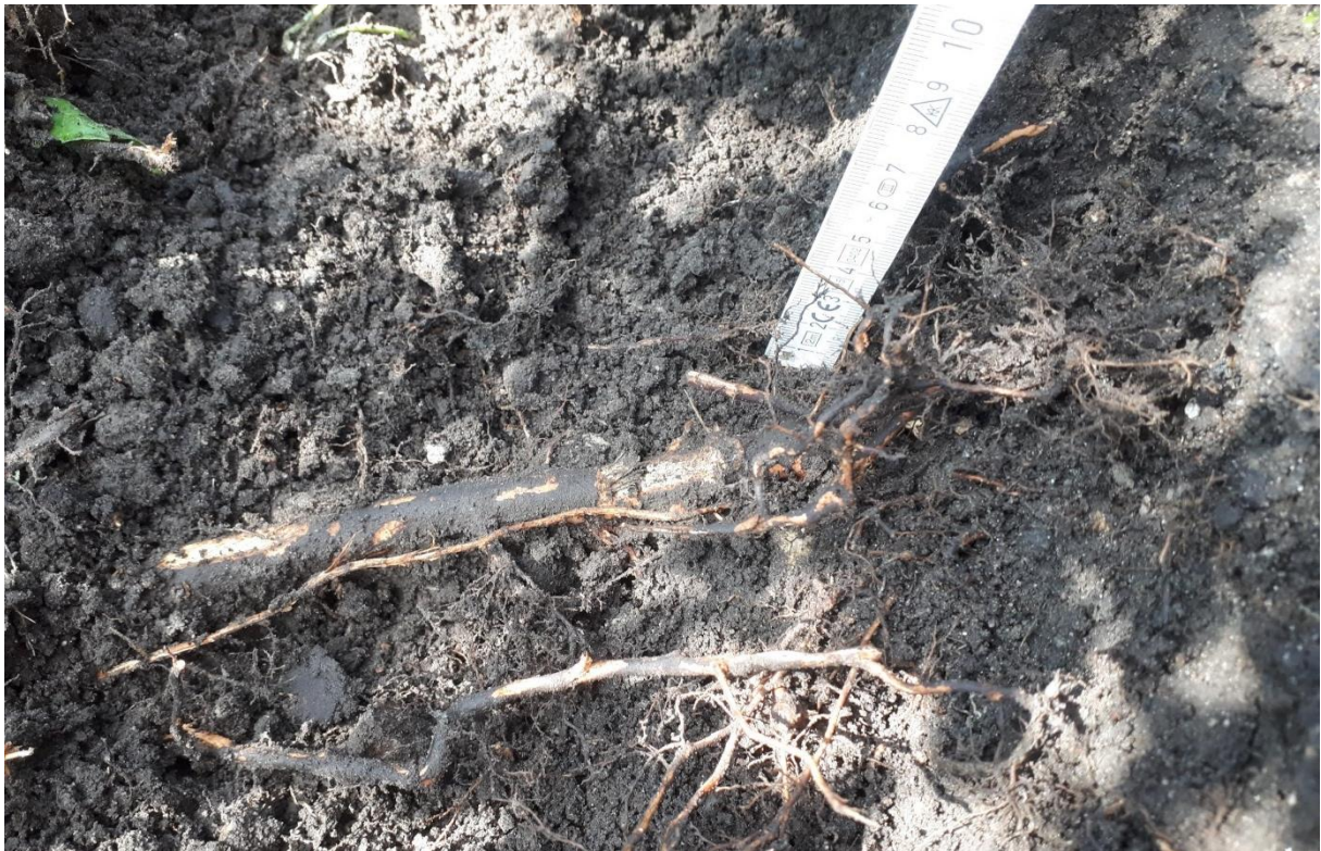
Afbeelding 2: Beworteling direct naast het pad: één grove wortel aangetroffen
